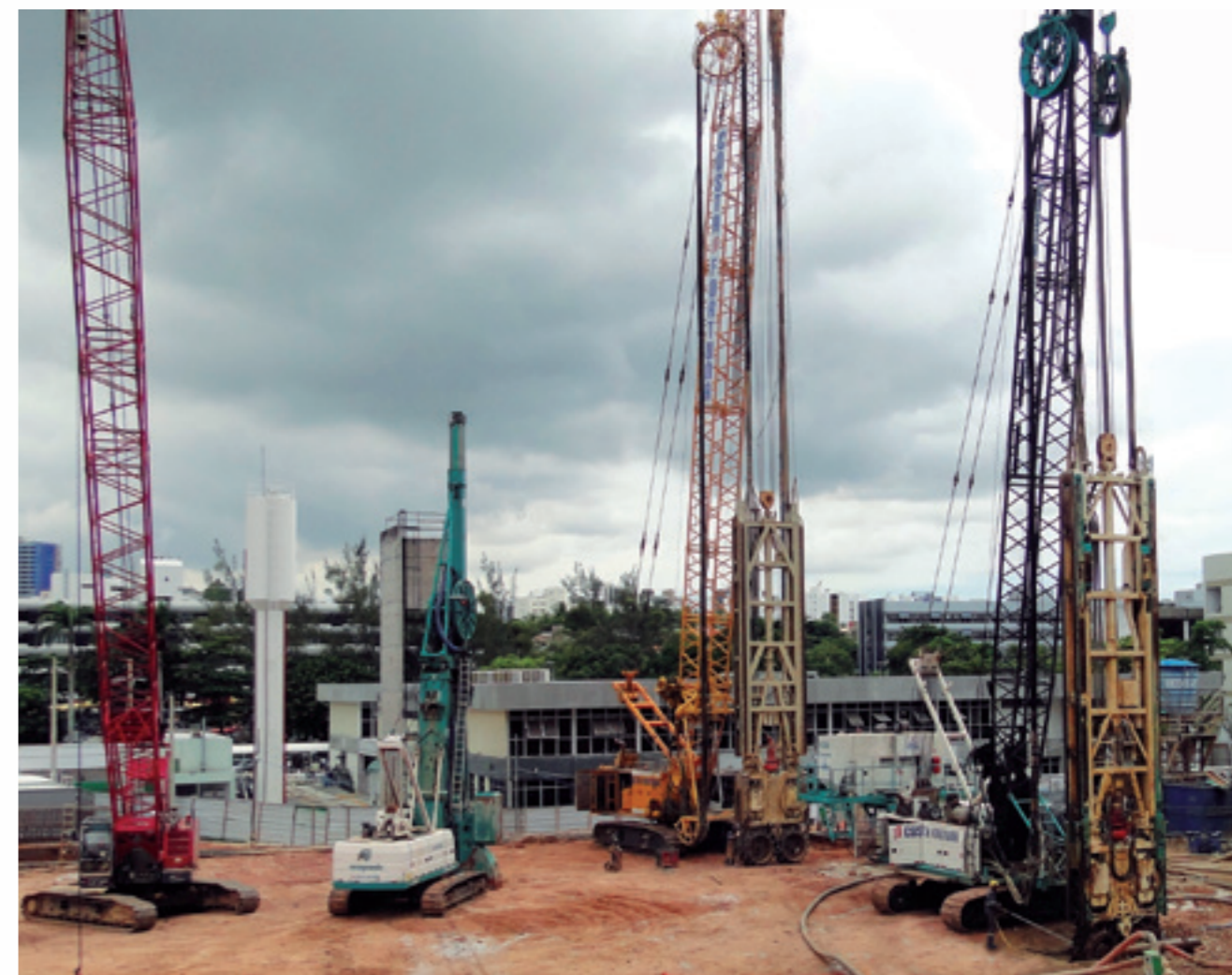
Conjuntos de guindastes e hidrofresas para execução de estacas barrete em rocha sã.
