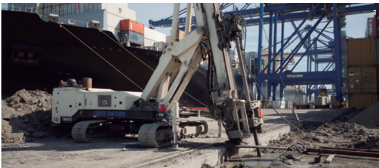
1, 2 e 3 - Execução de colunas MiniJet® inclinadas com uso de perfuratriz de ponta tecnológica para serviços especiais.
