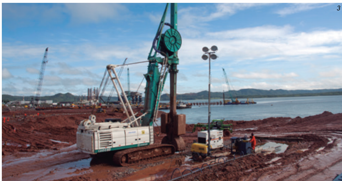
1 e 2 - Execução de parede diafragma em rocha com uso de Equipamentos Casagrande e Liebherr. 3 - Execução de parede diafragma com uso de clam shell hidráulico com torre e haste telescópica, monitorada eletronicamente.
