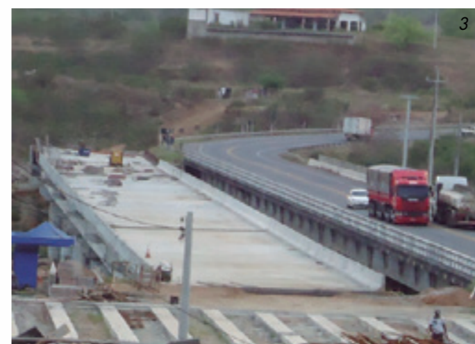
1 - Execução de estacas escavadas com equipamentos embarcados. 2 - Construção dos pilares da ponte. 3 - Vista da superestrutura da nova ponte.
