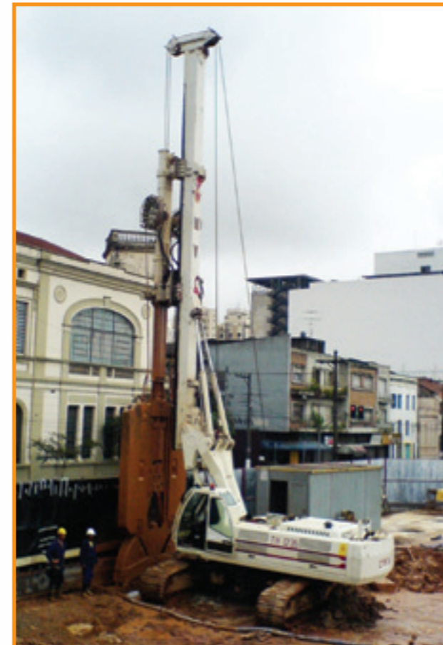
Execução de parede diafragma com uso de clam shell hidráulico no centro de São Paulo - SP
