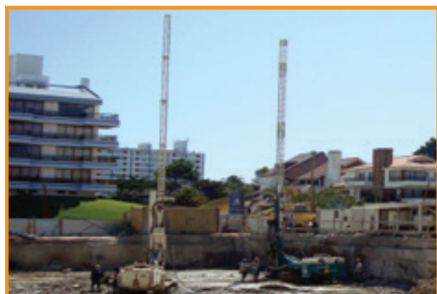
Perfuratrizes, bombas e misturadores para execução de jet grouting - Punta del Este - UY
