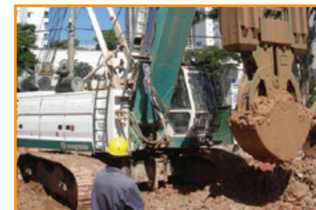
Execução de parede diafragma com uso de clam shell hidráulico em Belo Horizonte - MG
